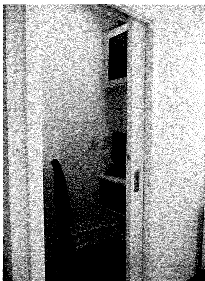
miestny rozhlas s kamerovým systémom po rekonštrukcii
