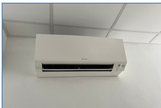
Klimatizačná jednotka vo vyšetrovacom krídle
