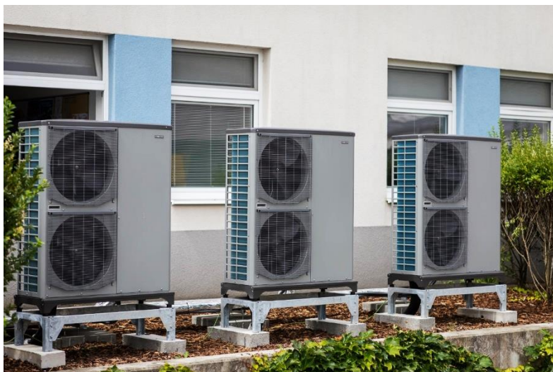
Obr. X Tepelné čerpadlá na stredisku údržby Nitra-Selenec
