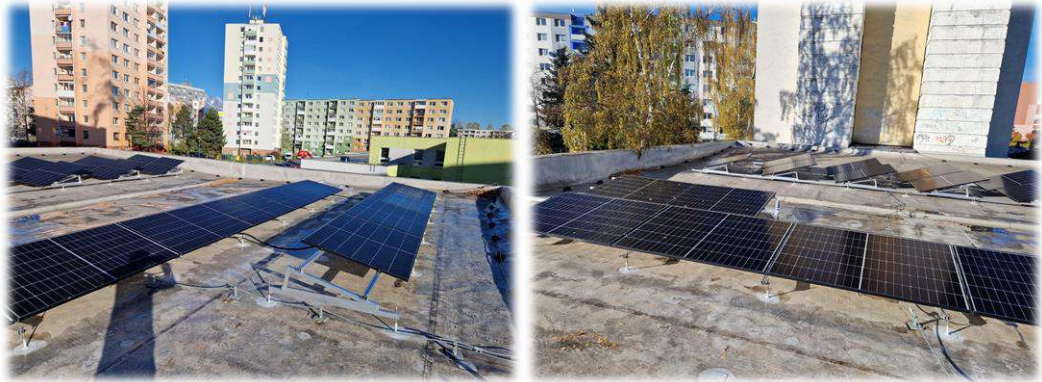
Fotovoltaické zariadenie – E 3/VI, ul. Šrobárova
