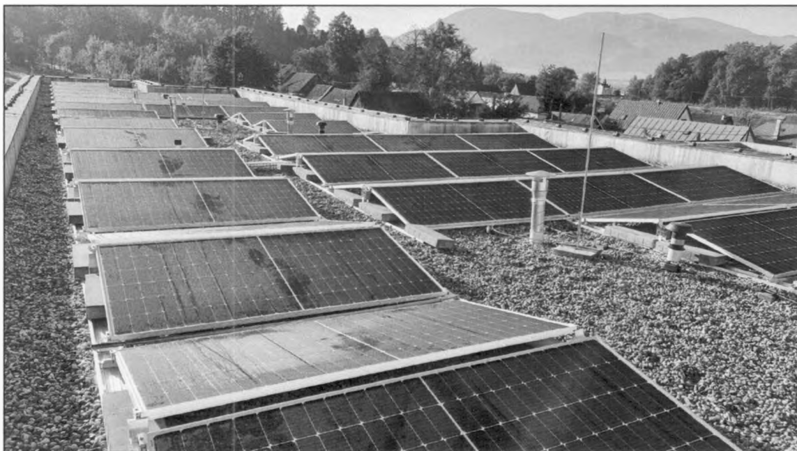
Fotovoltaické články na budove ZPS sv. Barborky
