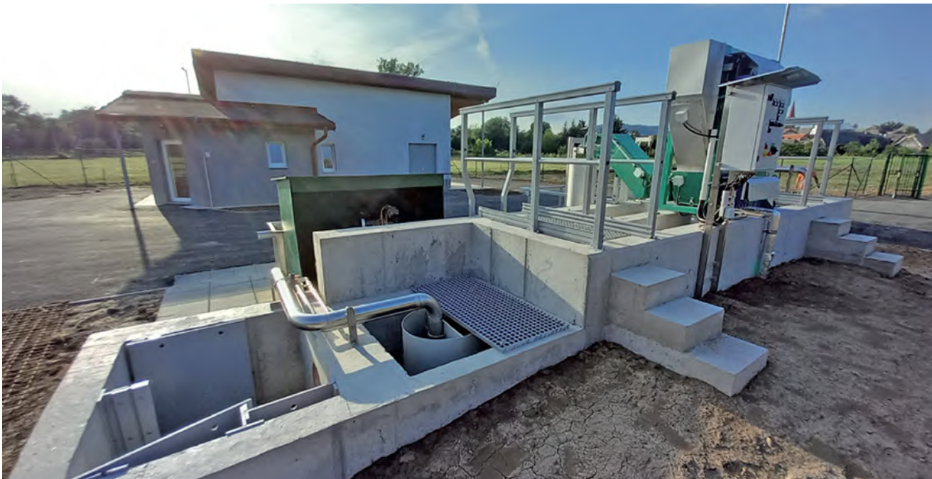
Sebechleby - kanalizácia a ČOV
