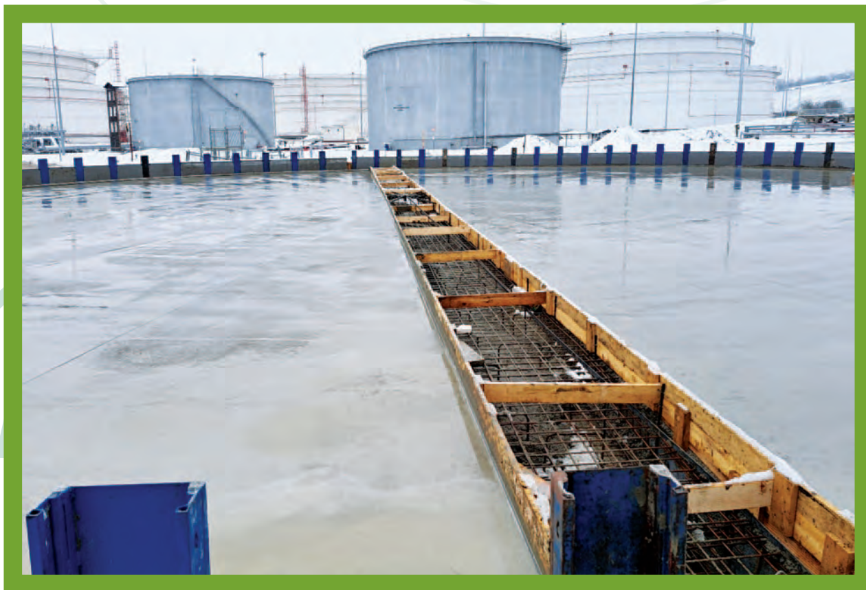
Obr.: Práce na základe novej nádrže požiarnej vody, v pozadí pôvodné nádrže požiarnej vody a odpadových vôd
