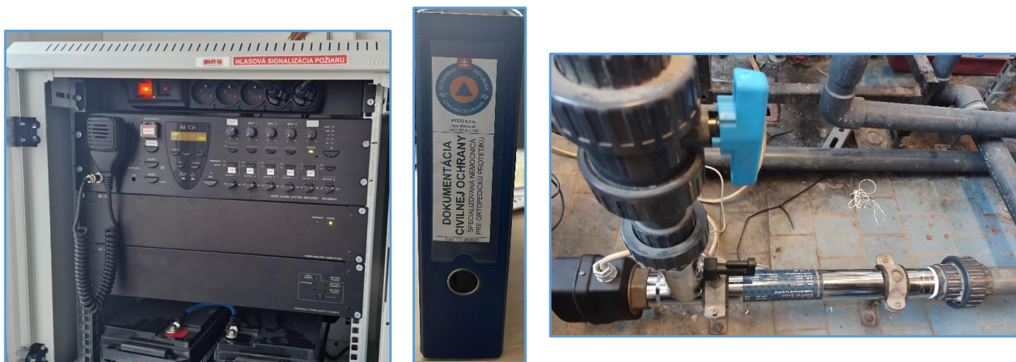
Obrázok 17: Modernizácia priestorov ŠNOP – HSP, civilná ochrana, ohrev bazéna
