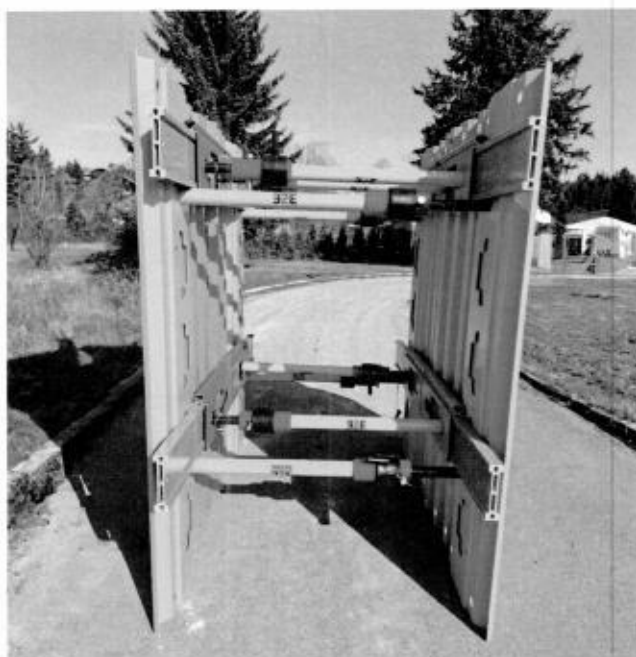
Pre zvýšenie bezpečnosti zamestnancov pri výkopových prácach spoločnosť v roku 2024 obstarala ľahké mobilné sklolaminátové paženia pre všetky prevádzky,
