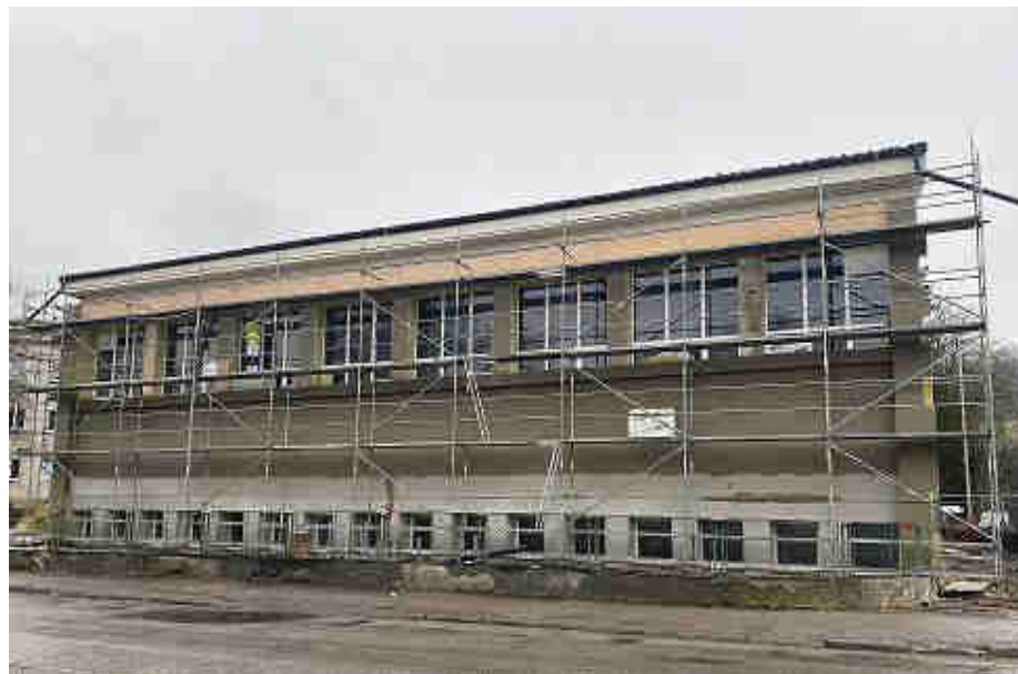
Sanácia a stavebné úpravy telocvične vrátane zázemia v SOŠ strojníckej Považská Bystrica
