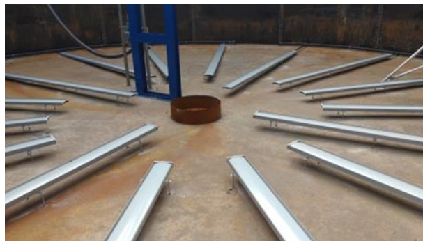
ČOV Dudince - prevzdušňovací systém
