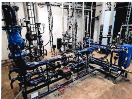
Odovzdávacia stanica v bytovom dome
