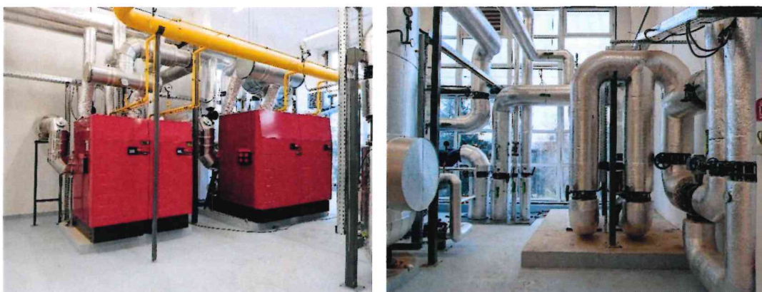
Kotolňa MIER plynové kotle a technológia
