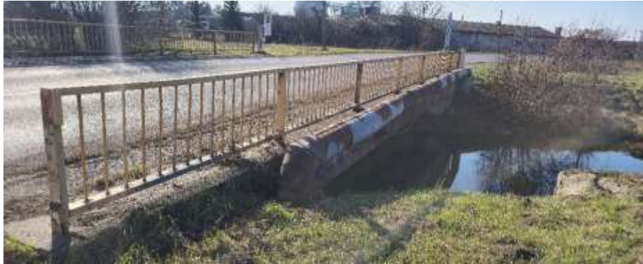
Most M5936 na ceste III/1496 cez potok v obci Nitriansky Hrádok - pôvodný a nový stav:
