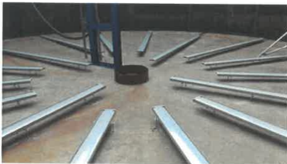
ČOV Dudince - prevzdušňovací systém
