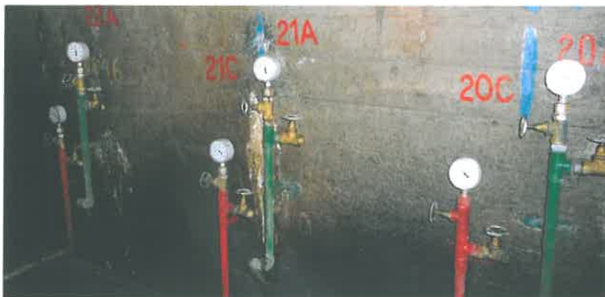
Meracie zariadenia na vodárenskej nádrži Hriňová
