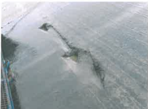
Po náraze neznámou loďou vznikli na asfaltobetónovom plášti prívodného kanála do Gabčíkova takéto trhliny
