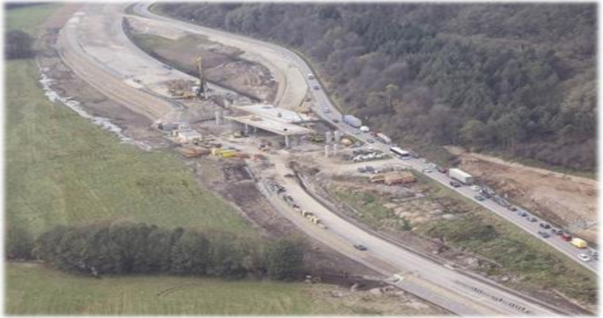
Obr. č. 12 Rýchlostná cesta R2 Pstruša – Kriváň, výstavba mostu na R2 ponad preložku cesty I/50
