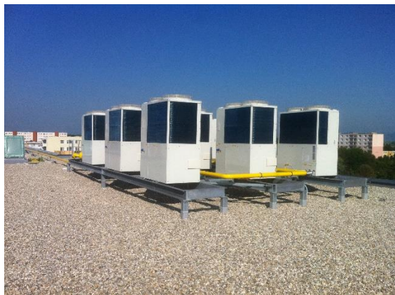
Vonkajšie jednotky – plynové tepelné čerpadlá
