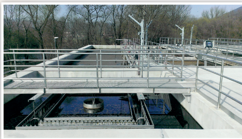
ČOV Liptovská Teplá
