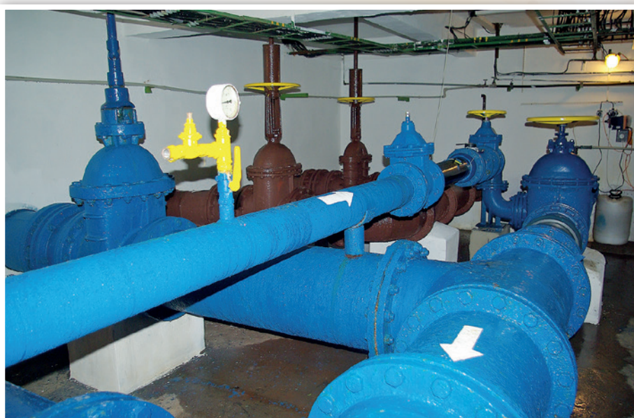
Vodárenský objekt prerušovací vodojem Liptovská Osada 150 m 3 – armatúrna komora
