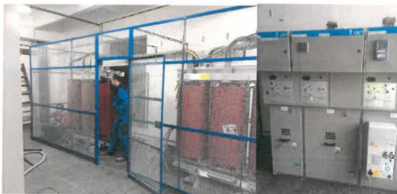
Obr.č.4 Nová trafostanica TS 0045 -288
