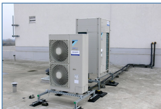
Klimatizácia na DSS – vonkajšia jednotka
