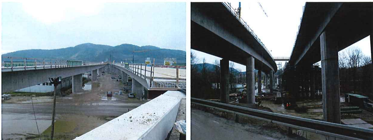
Obr. č. 11 a 12 Výstavba estakády ponad cestu I/18, trať ŽSR a Hričovskú nádrž – objekt 223
