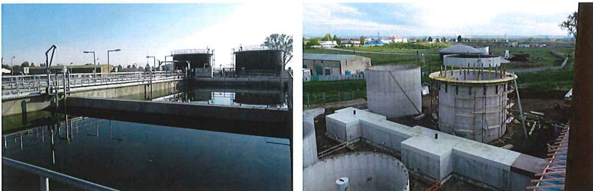
Obr. č. 52 a 53 Aktívne nádrže a kalojemy
