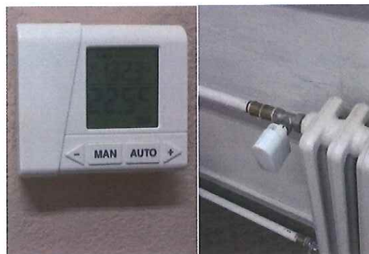
Bezdrôtová regulácia vykurovania systémom IQRC bola nainštalovaná v ZŠ Juraja Fándlyho celá výška investície 73 285,72 €
