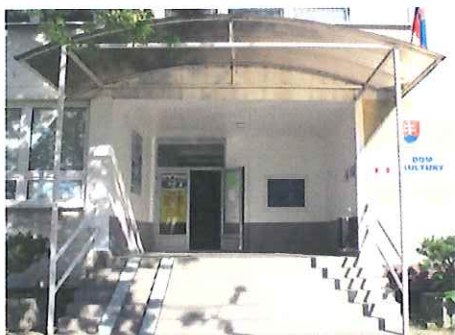
Rekonštrukcia vchodu do Domu kultúry, nová dlažba na prízemí, okno, nové dvere, rekonštrukcia vrátnice a skladu v hodnote 32 000 €.
