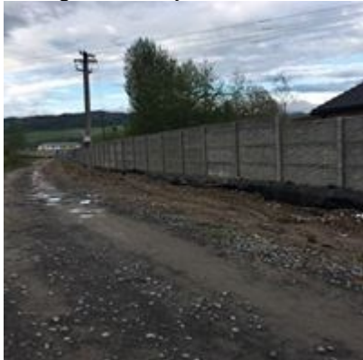
Protipovodňový múr ul. Kvetná
