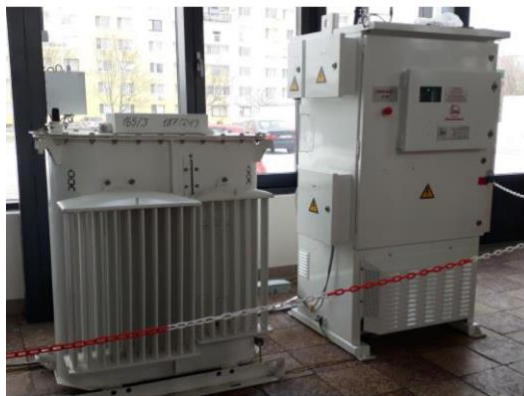
Transformátor a frekvenčný menič čerpadla
