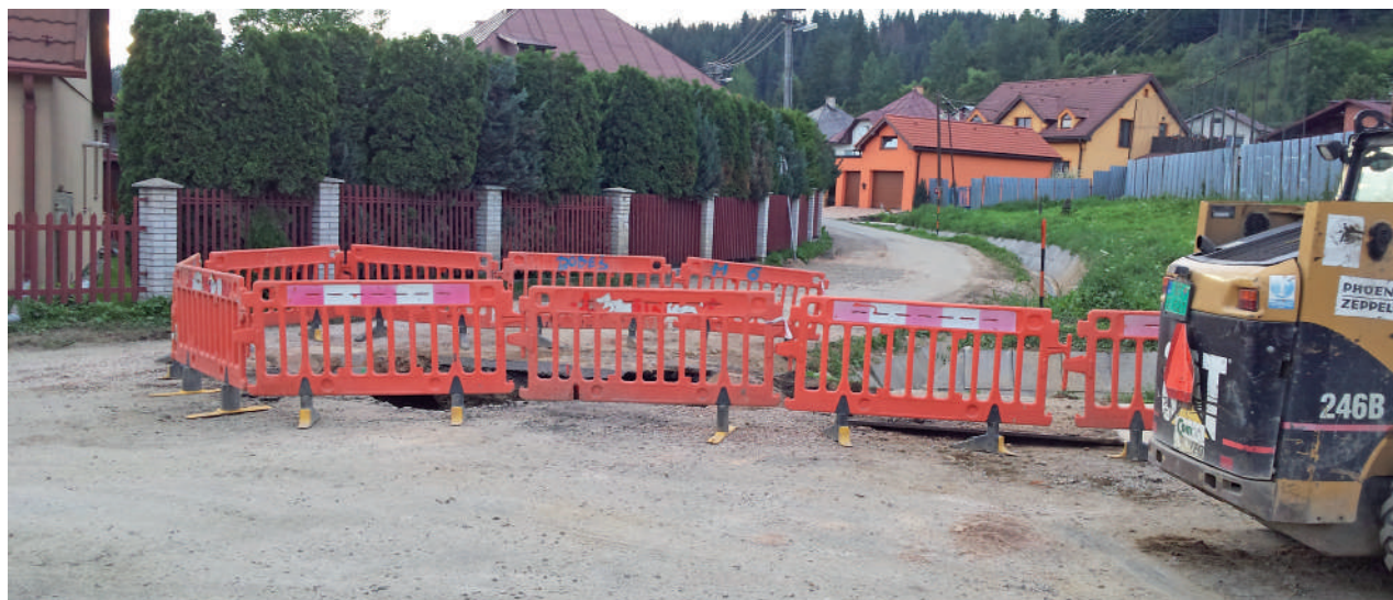
Pohronská Polhora - kanalizácia
