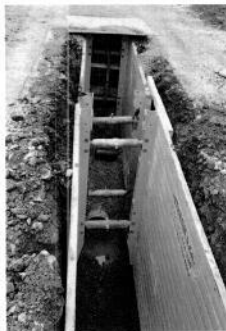
V roku 2021 bola zahájená stavba verejnej kanalizácie v obci Breza v rámci operačného programu IROP.
